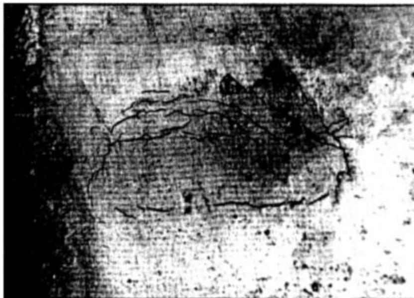
Рис. 3.10. Сетчатое растрескивание под рельсовой опорой (выявлено после удаления опоры)
